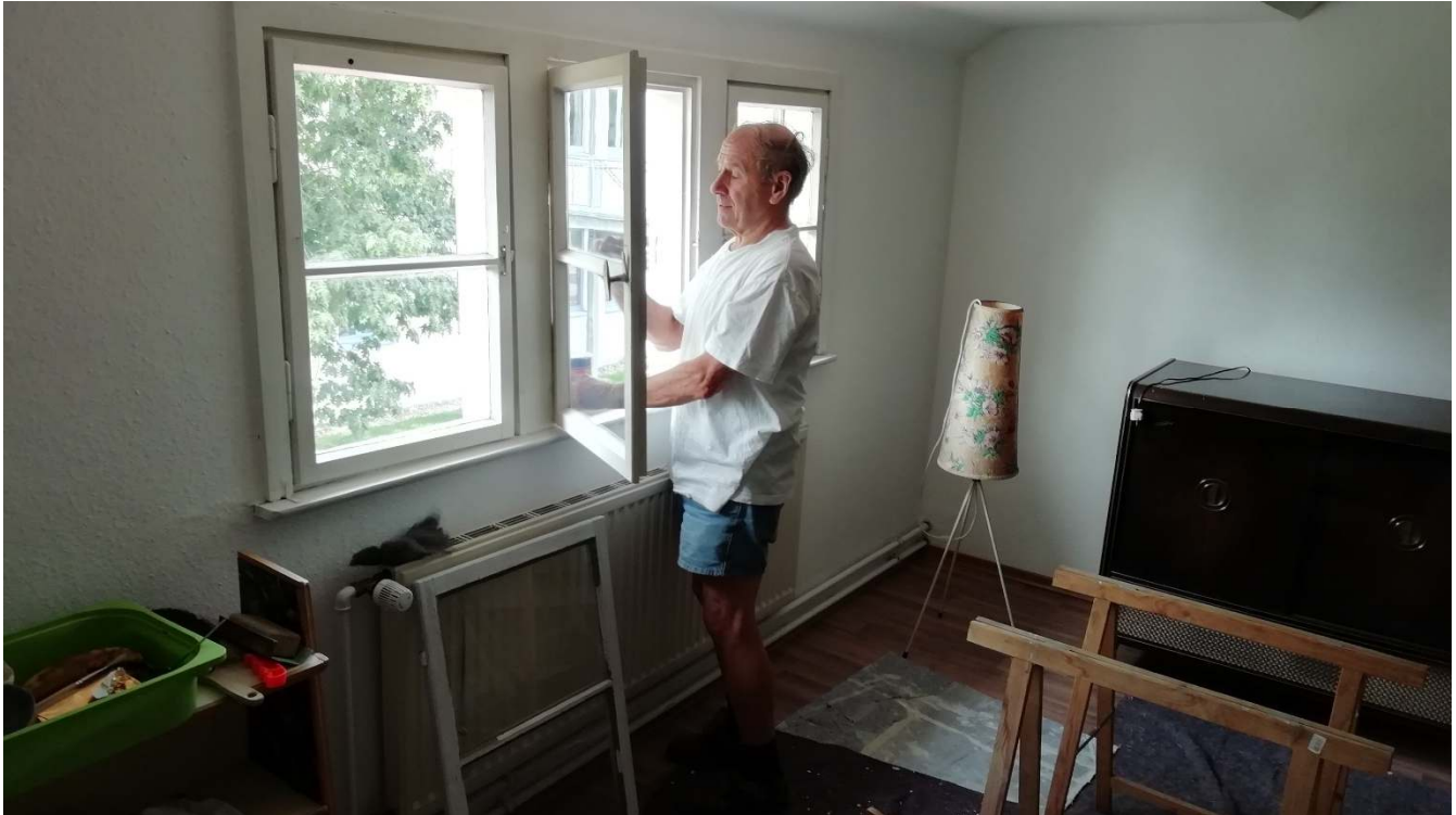
Die meiste Arbeit beim Streichen der Fenster war das Abschleifen. Willi Kempfer (Herbertshofen) bei der Arbeit.
